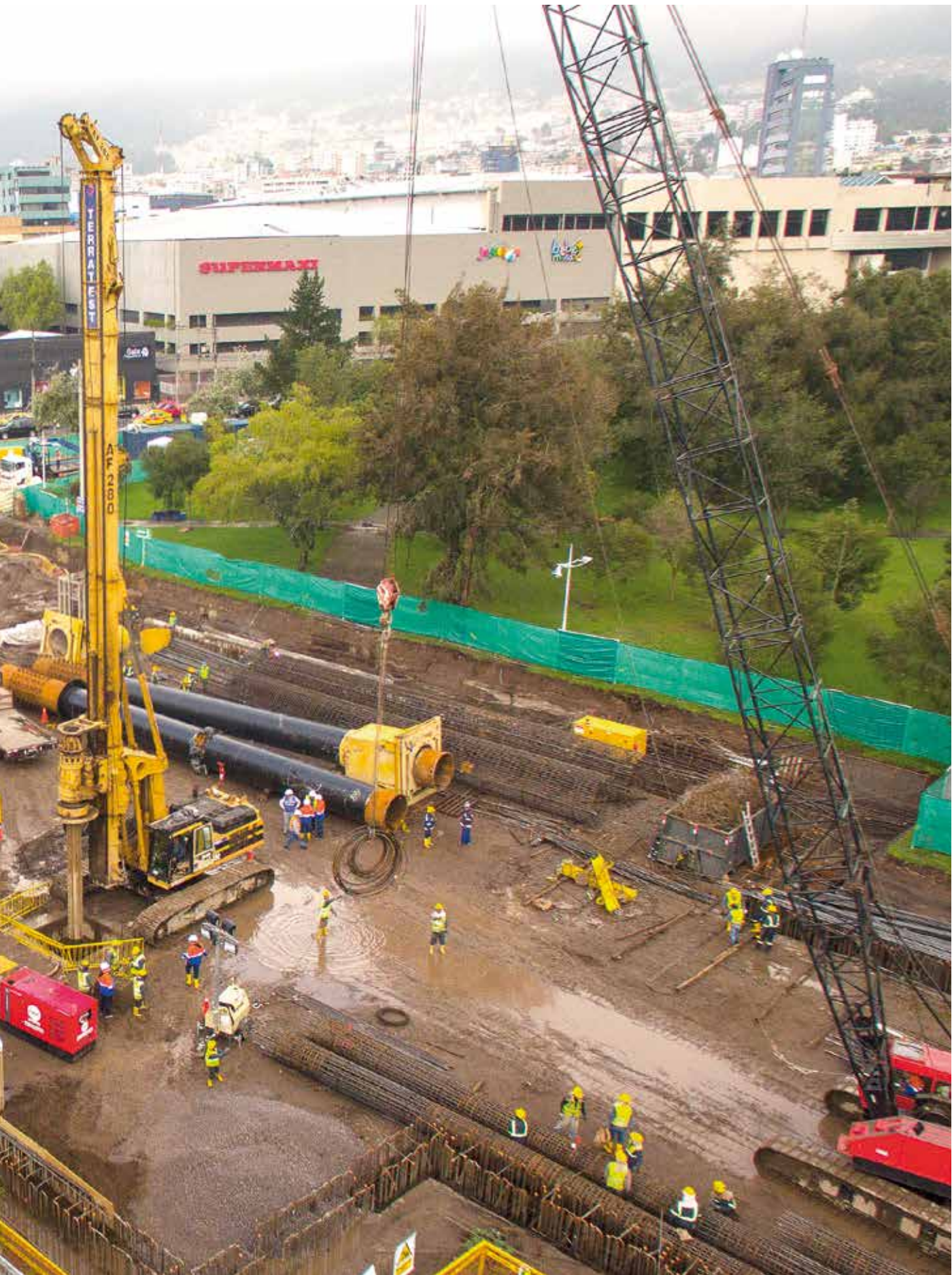
Estación La Carolina , Metro de Quito, Ecuador Muro Pantalla, Pilotes In situ, Jet Grouting, Inyecciones Compensación
