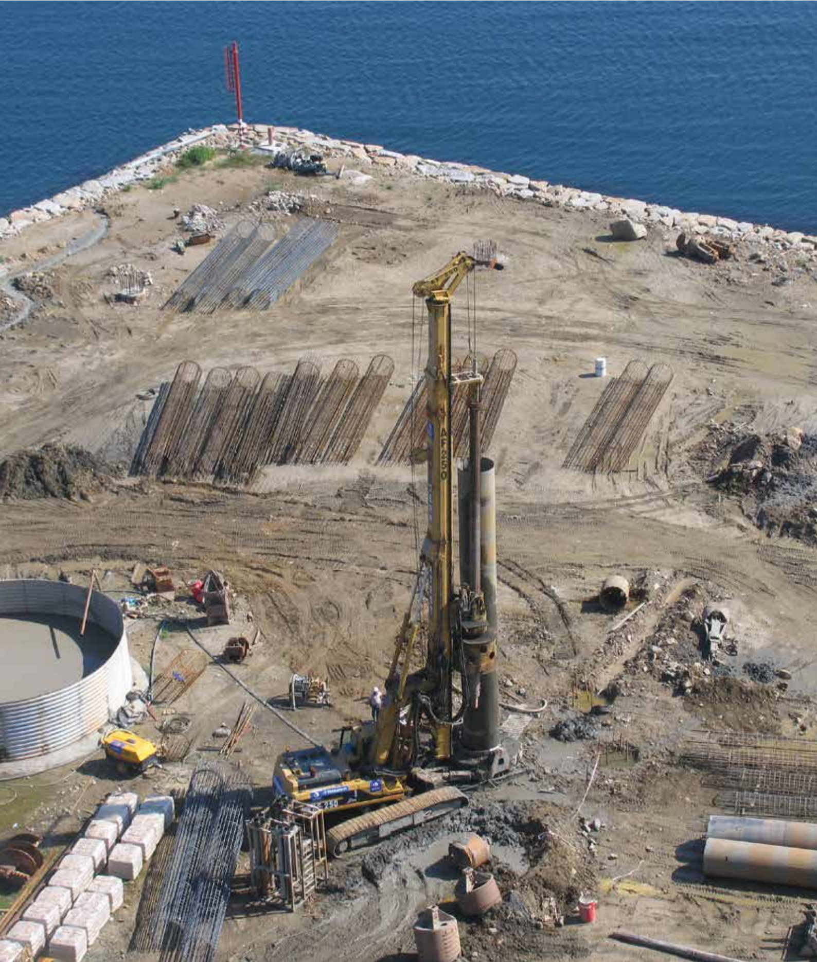
Cubierta de Transferencia de Carbón Proyecto Medusa. A Coruña Pilotes In situ
