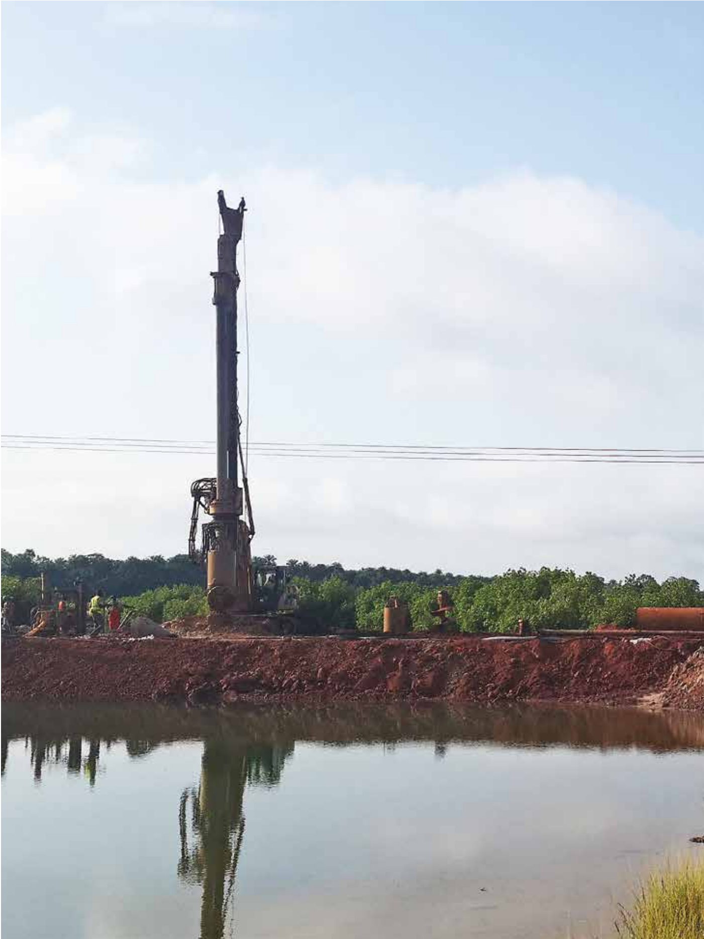
Carretera RN6 Tanaff Kolda Lote 1, Lote 2 y Puente Kolda, Senegal Pilotes In situ
