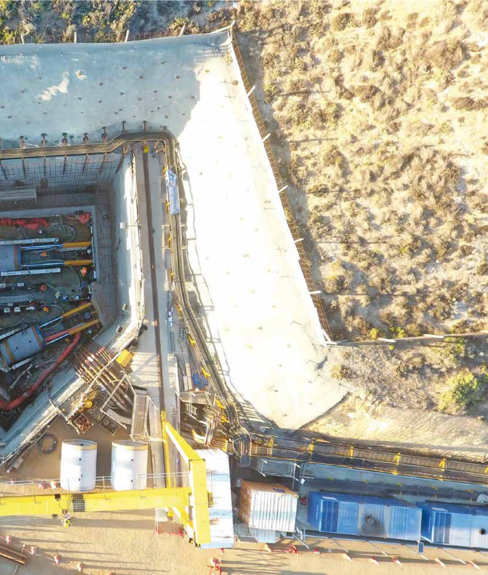
Planta Desalinizadora Los Pelambres, Chile 2 Hincas de Tubería con Hidroescudo AVN 2000; AVN 1800
