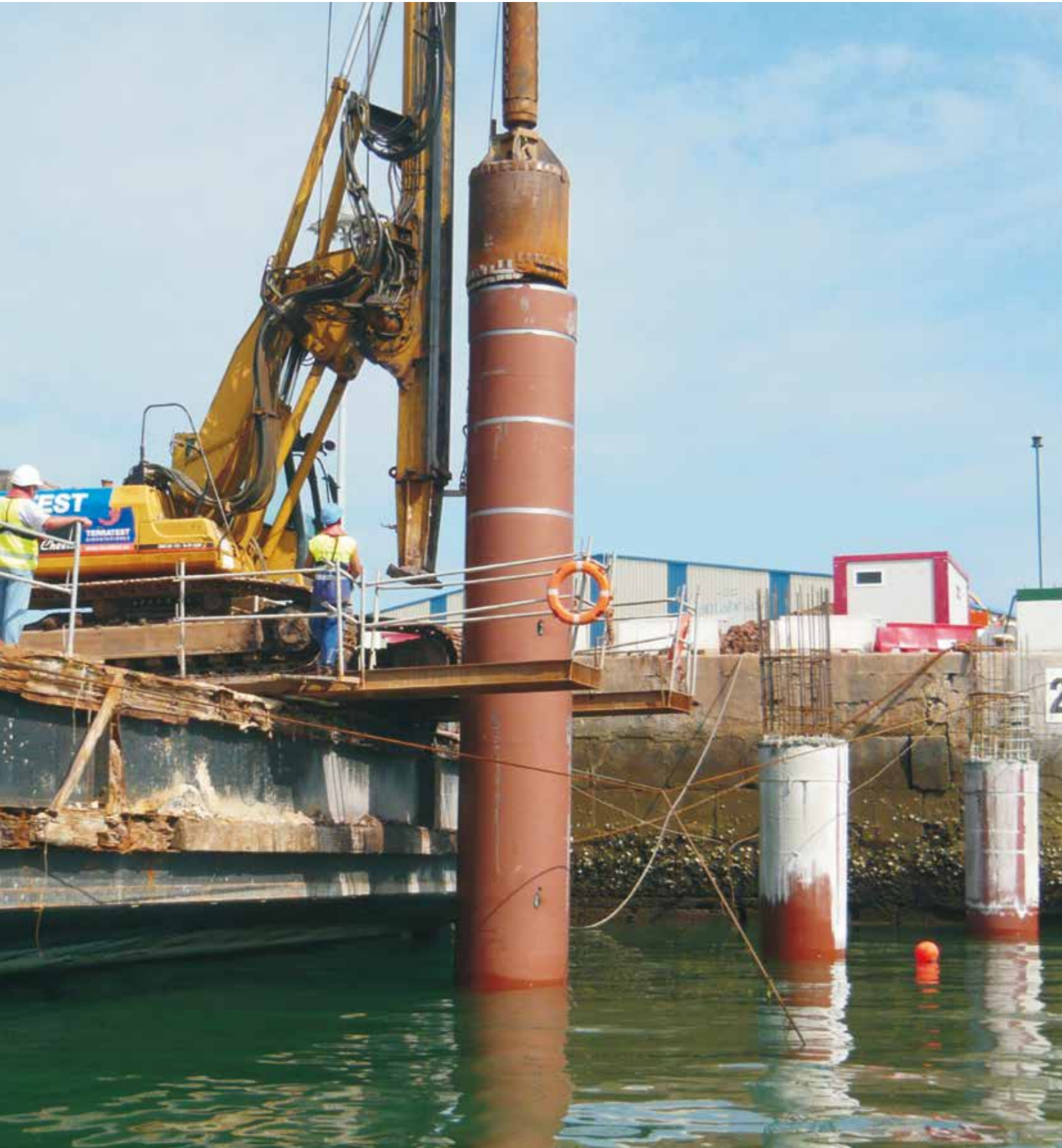
Puente Levadizo en el Muelle de Maliaño. Puerto de Santander. Cantabria Pilotes In situ
